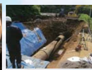
老朽化した用水管の破損
