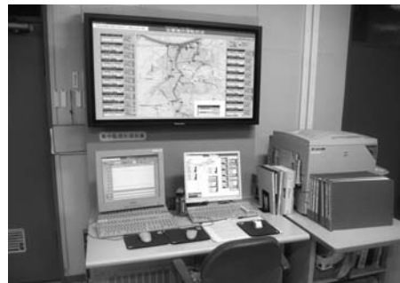
遠方監視制御装置 (根木名川土地改良区事務所内)
