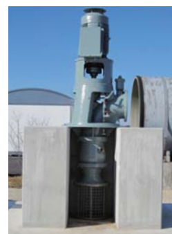
▲旧第三揚水機場ポンプ
