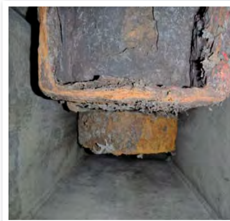
▲腐食と錆つきで、動かない ローラーゲートのローラー
