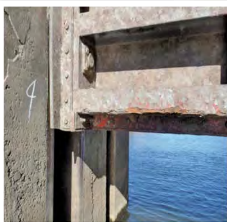
▲鋼製扉体の腐食状況
