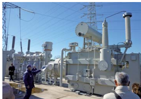
連系変圧器で154kVへ
