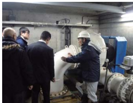
発電機の説明
