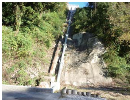
発電のための導水路
