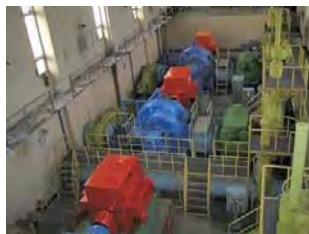
▲笹川揚水機場 ポンプ設備
