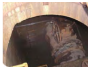
▲管水路 バルブ類の腐食
