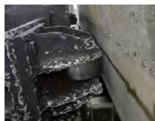
▲吉崎堰 サイドローラー取付部の腐食
