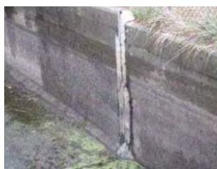
▲西幹線 大きな段差と目地の変状
