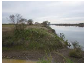
河川合流部(右岸) 復旧前
