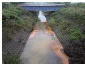
張りブロック区間 復旧前
