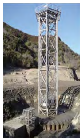
▲更新後の取水設備
