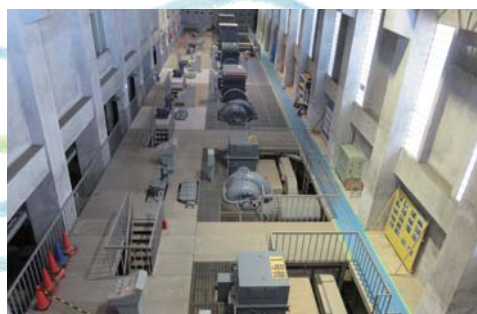
▲房総導水路横芝揚水機場ポンプ室
