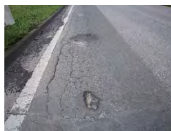
▲舗装の劣化状況写真
