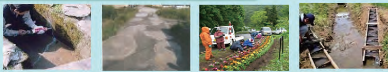
水路のひび割れ補修 農道の窪みの補修 植栽活動 水田魚道の設置
