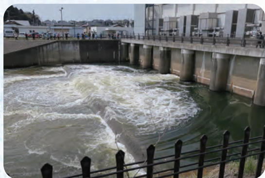
▲大和田排水機場 試運転時写真
