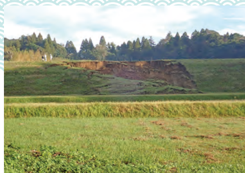
着工前(被災状況)
